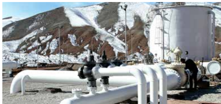
پروژه تلمبه خانه ها و تاسیسات خط لوله نفت خام نکا - ری (تکمیل شده)
