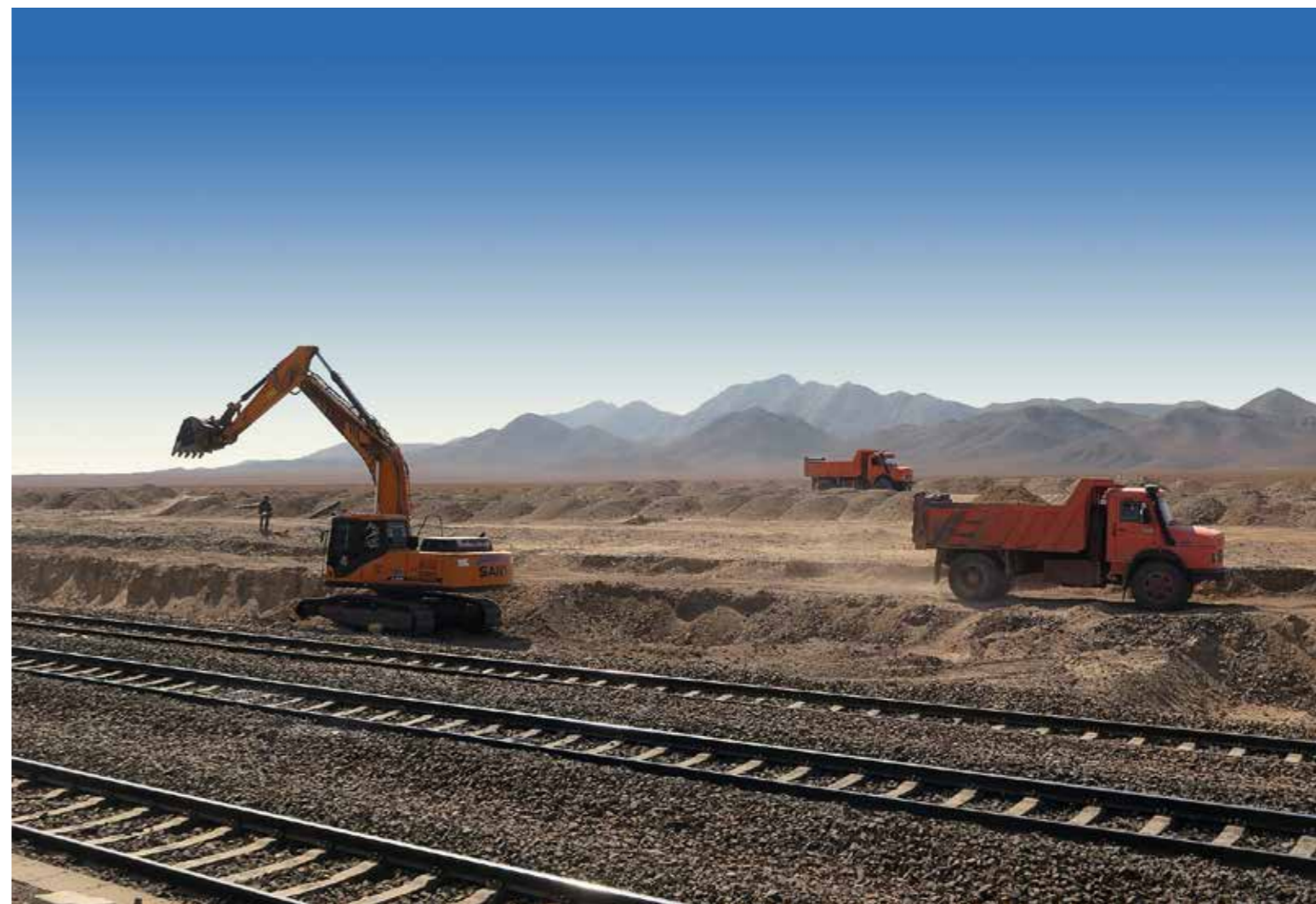
پروژه دو خطه کردن راه آهن محور شبنم - مشک (در دست اجرا)
